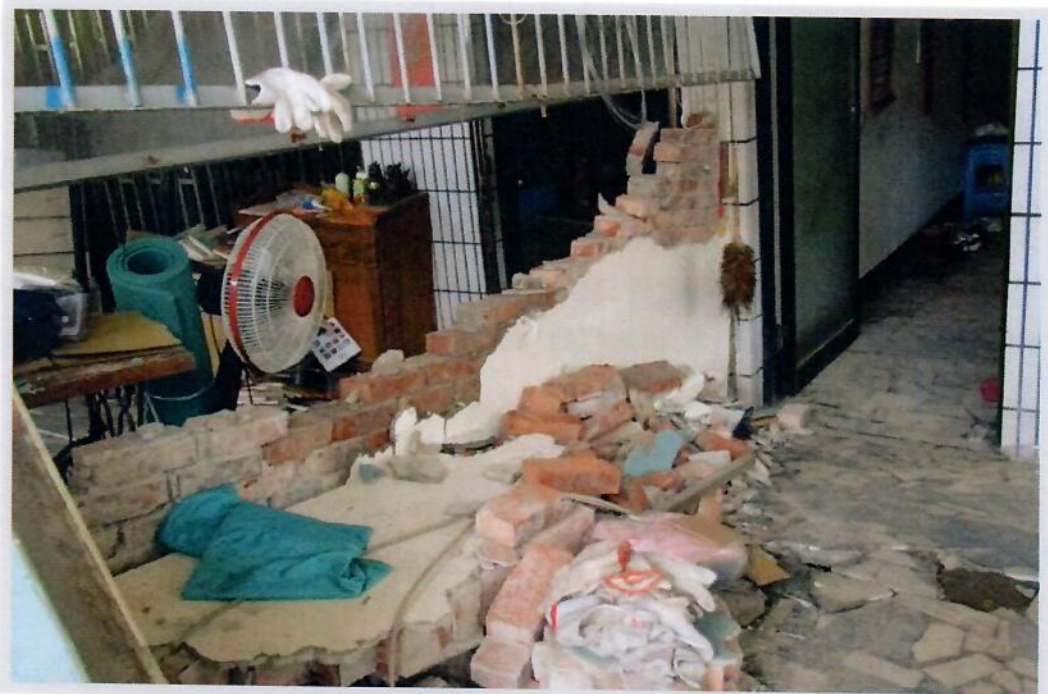
土壤液化、軟弱黏土層導致建築物沉陷、傾斜等問題，事前可用工程手段，如挖除土層、打基樁等方式克服；事後可透過頂升扶正、灌漿工法補救，但所費不貲。圖為示意照。(中央社檔案照片)
