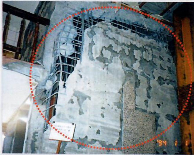
建築安全履歷在921地震和206地震後更顯重要。建築結構每個細節馬虎不得，若一根柱沒做好，地震一來歪倒，整棟建築可能跟著歪。圖為地震造成建物毀損。中央社記者韋樞台北傳真105年5月22日
