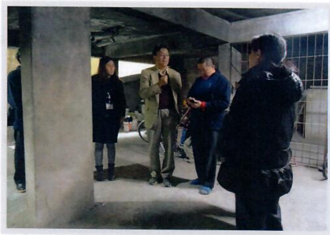
全台約52萬棟老舊住宅適用老屋健檢補助。圖為新北市府都市更新處與結構技師，赴板橋區國泰街一棟35年老屋場勘，地下室16根結構柱有8根龜裂。(圖新北市都更處提供) 中央社記者陳政偉傳真 105年5月22日
