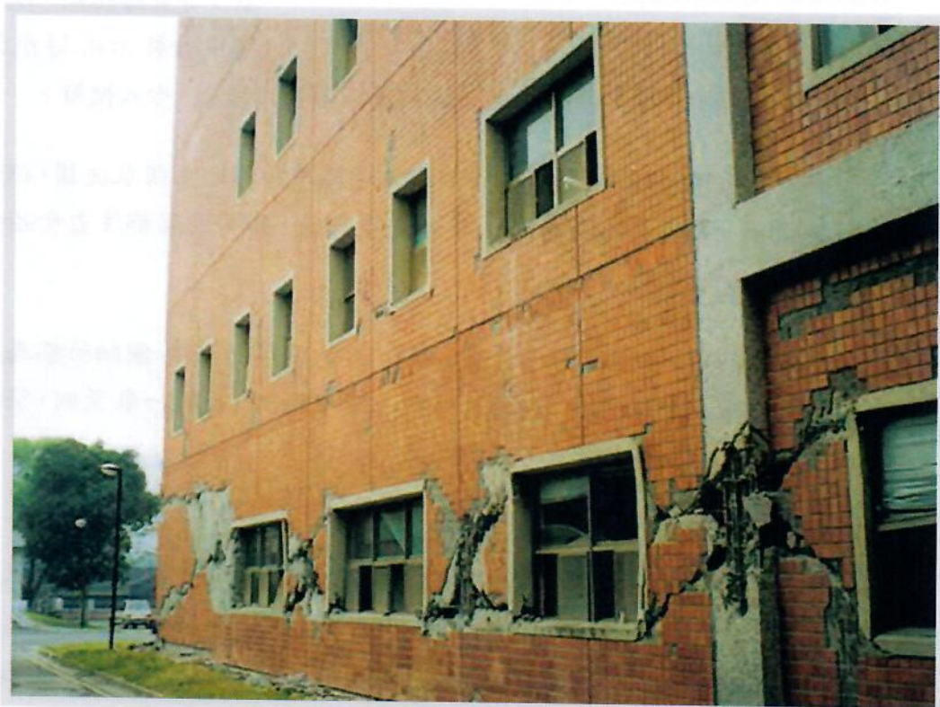
建築安全履歷在921地震和206地震後更顯重要。建築結構每個細節馬虎不得,若一根柱沒做好,地震一來歪倒,整棟建築可能跟著歪。圖為地震造成建物毀損。中央社記者韋樞台北傳真 105年5月22日
