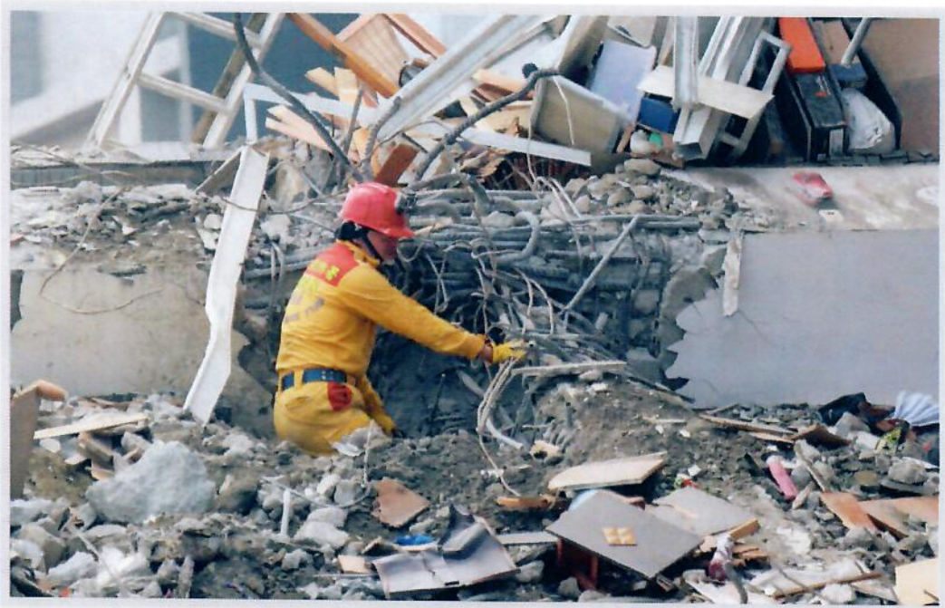
206強震震垮維冠金龍大樓，造成115人死亡，慘劇再度曝露一案建商的嚴重問題。圖為台南維冠金龍大樓搶救情形。(中央社檔案照片)
