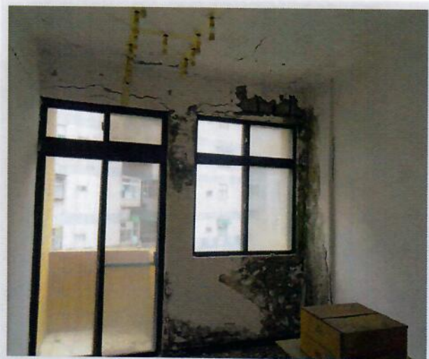
全台約52萬棟老舊住宅適用老屋健檢補助。新北市政府都市更新處會勘淡水一處老舊房屋，從室內往陽台看去，水泥牆面斑駁脫落，建築結構須進一步了解勘查。(圖新北市都更處提供) 中央社記者陳政偉傳真 105年5月22日
